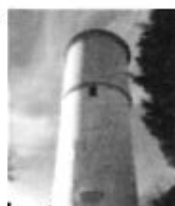
CHAYRES HS Mise en service 1960 CAPACITÉ 150 m 3 pompes 2 x 5 m 3 h
